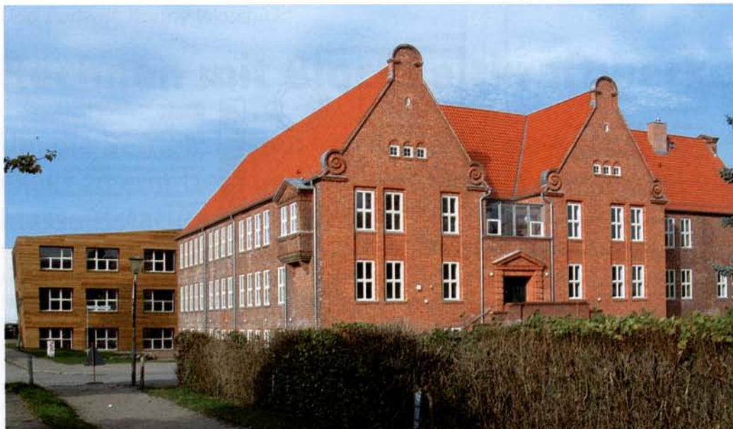
Alt- und Neubau der Jona Schule in Stralsund werden per Fußleistenheizung beheizt. Die Regelung erfolgt über die thermozyklische Einzelraumregelung.
